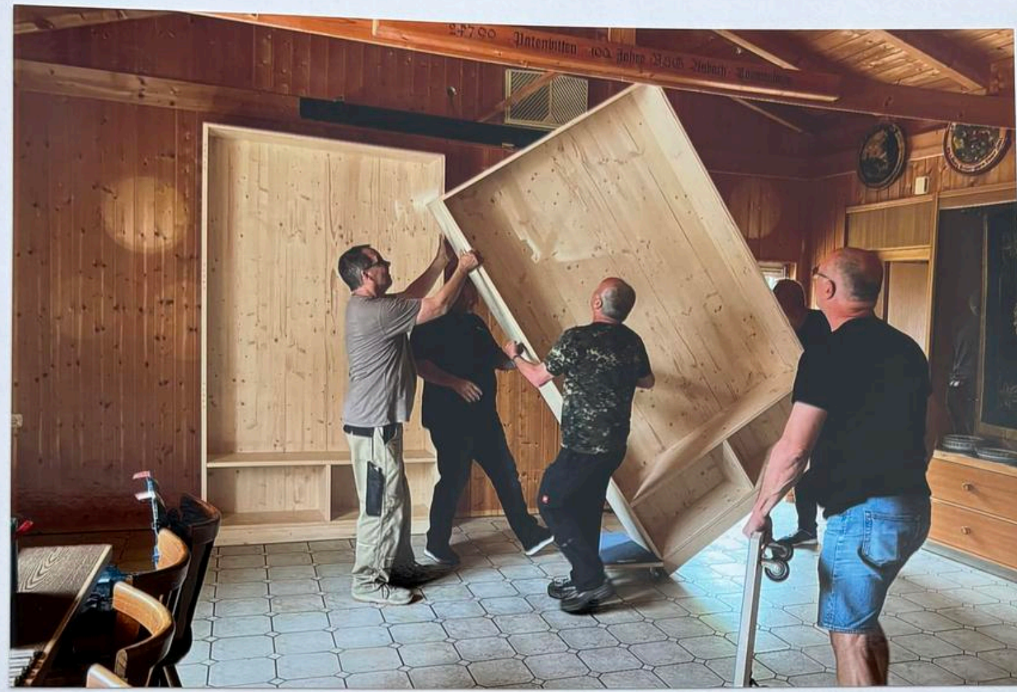
Otto Gerstner, Guido Koerfgen, Norbert Singer, Artur Schmidt und Thomas Barfüßer bauten den Bogenschränk, der erst im Januar 2024 angeschafft und aufgebaut wurde, wieder ab. Da er aus massivem Holz gebaut ist, hat er das Hochwasser nahezu unbeschadet überstanden und wurde eingelagert.
